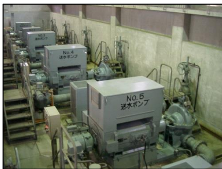
<右岸増圧ポンプ場>
