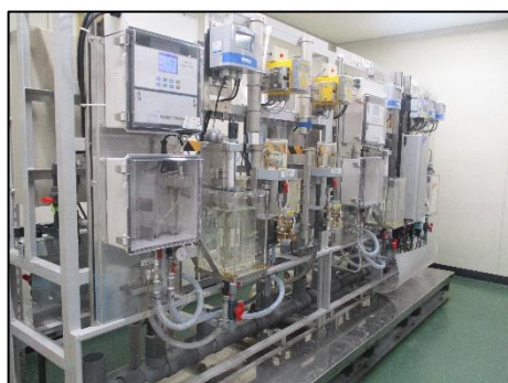
<自動水質監視装置>
