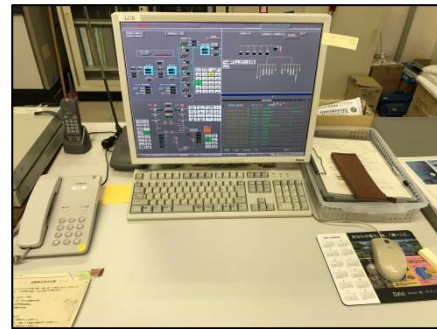
<右岸増圧ポンプ場操作室>
