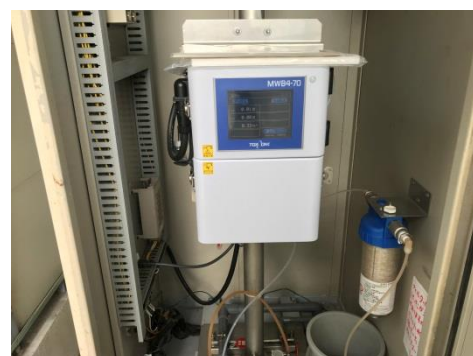
< 自動水質監視装置 >
