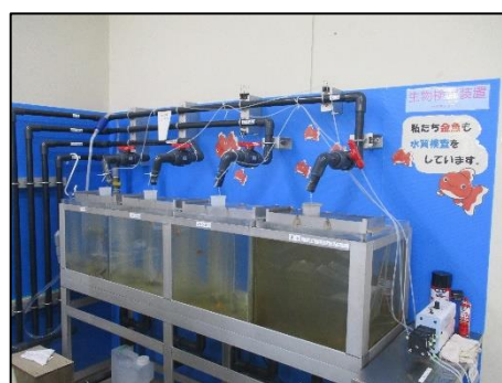
<魚類監視装置>
