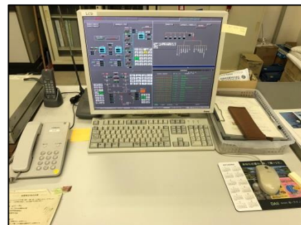
＜右岸増圧ポンプ場操作室＞
