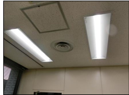
＜庁舎内LED照明＞
