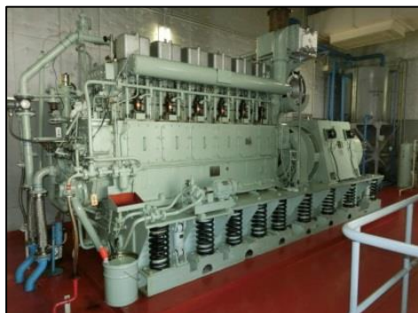
<浄水場自家発電装置>
