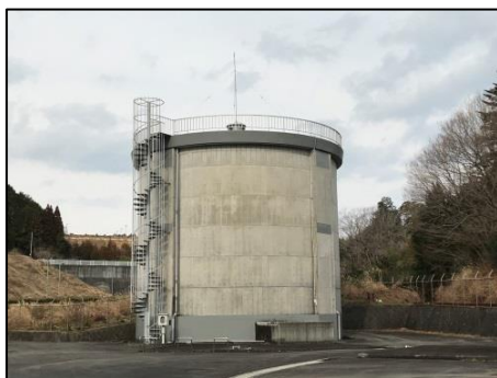
＜右岸増圧ポンプ場ポンプ井＞
