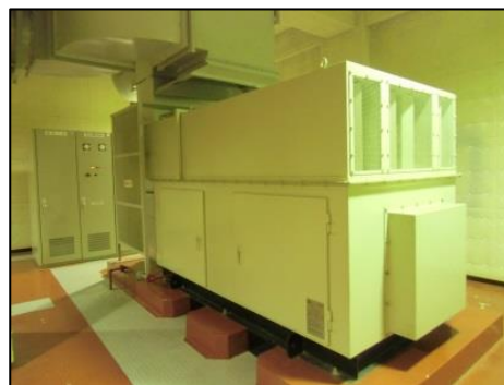
<右岸増圧ポンプ場自家発電装置>
