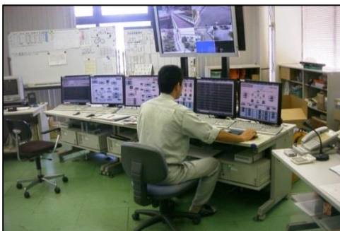
＜浄水場中央監視制御室＞
